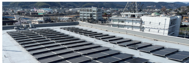
太陽光発電設備（御荘文化センター）
