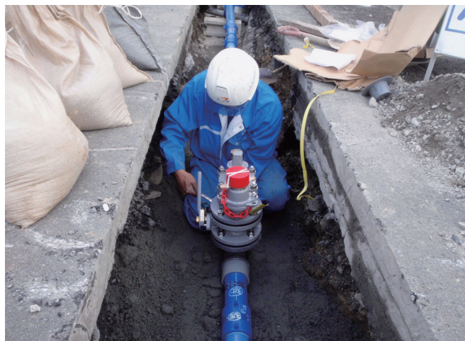
管路の耐震化
