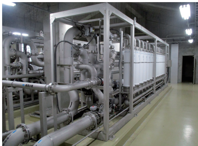
御荘浄水場膜ろ過装置
