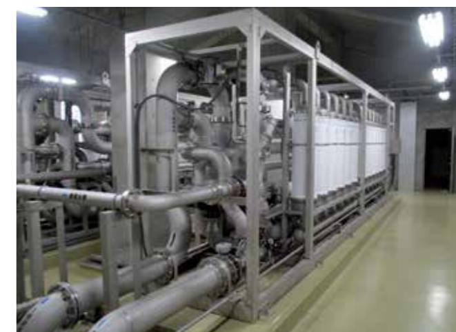
御荘浄水場膜ろ過装置
