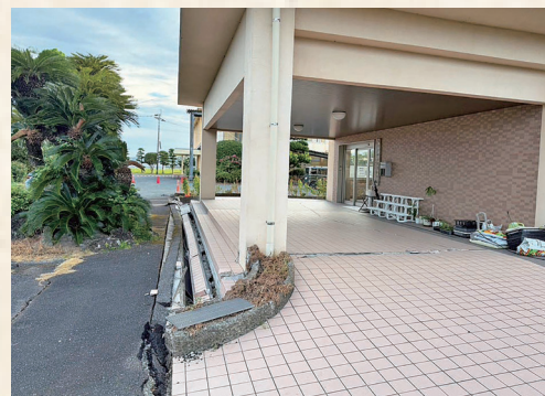
隙間と段差ができた学校施設
