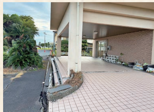
隙間と段差ができた学校施設
