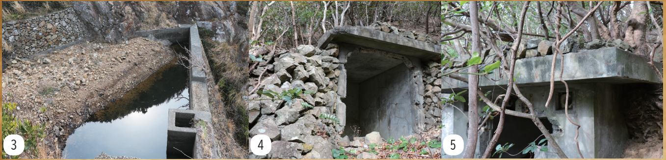
3 貯水池には豪雨の影響で大量の土砂が流れ込む
