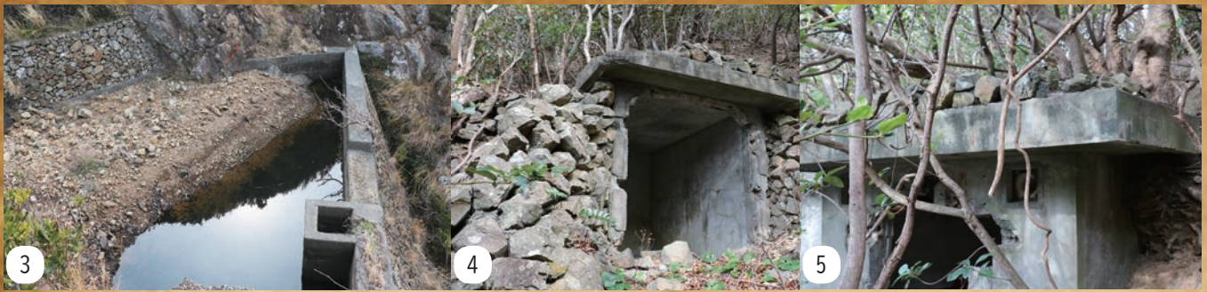
3 貯水池には豪雨の影響で大量の土砂が流れ込む
