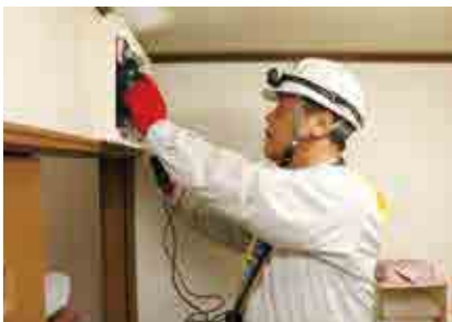
独居高齢者宅で漏電調査を行う南宇和電気工事組合の会員
