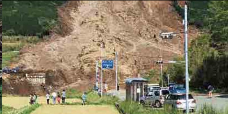
阿蘇大橋崩落現場
