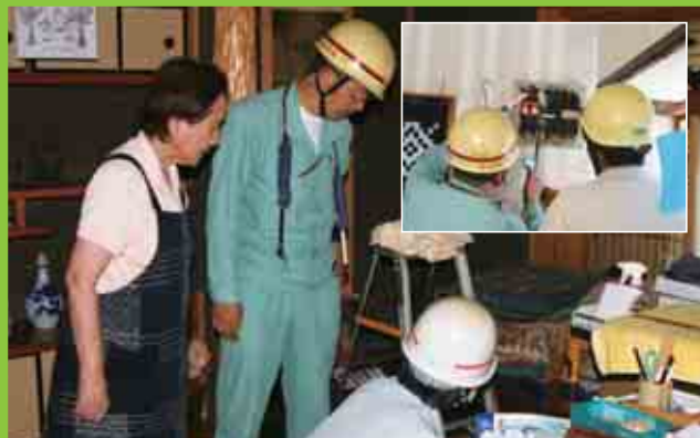
8月の「電気使用安全月間」にあわせて夏場の電気事故を防止しようと、南宇和電気工事組合(西崎良文理事長、21業者が加盟)が、城辺地域の独居高齢者15世帯の漏電調査と電気配線点検を行いました。(8/26)
