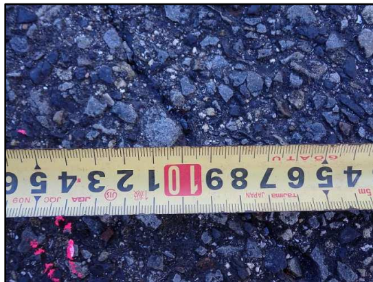
アスファルト舗装損傷状況（ひび割れ）
