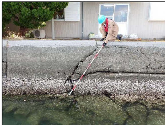
本体工損傷状況（ひび割れ）
