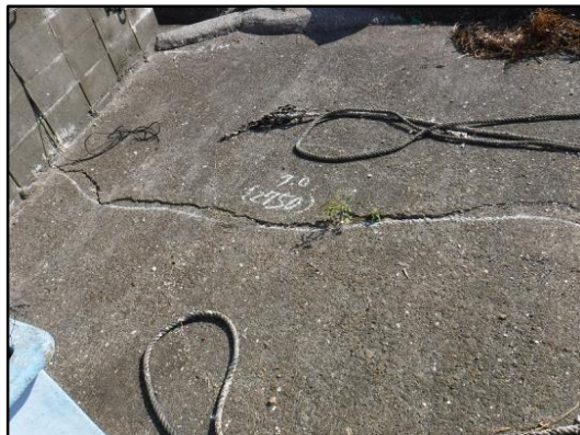
エプロン舗装損傷状況（ひび割れ）
