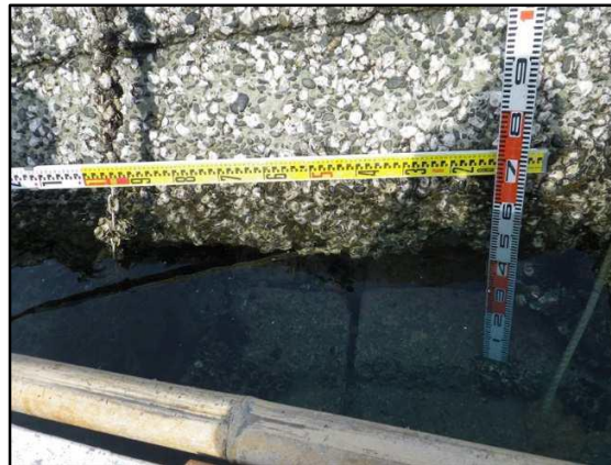
本体工損傷状況（欠損）
