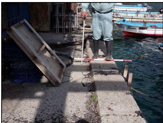
エプロン舗装損傷状況（沈下）
