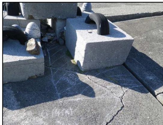
エプロン舗装損傷状況（うき）
