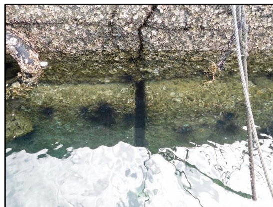
上部工損傷状況（開き）
