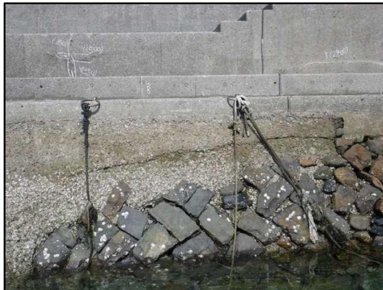
本体工損傷状況（ひび割れ）
