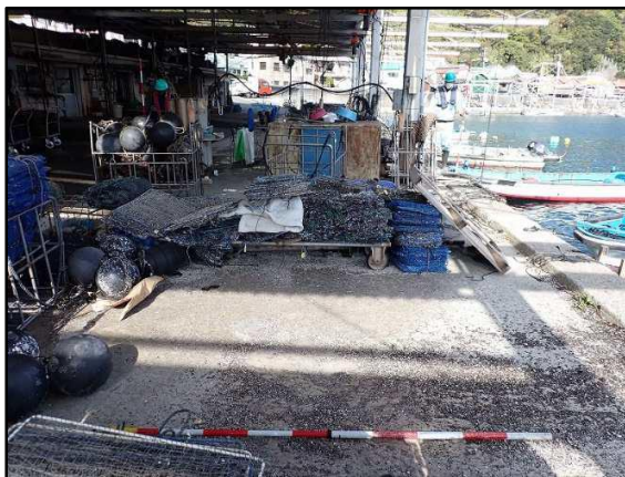
エプロン舗装損傷状況（ひび割れ）
