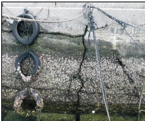
上部工損傷状況（ひび割れ）
