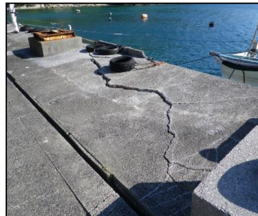
エプロン舗装損傷状況（ひび割れ）
