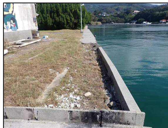
エプロン舗装損傷状況（消失）
